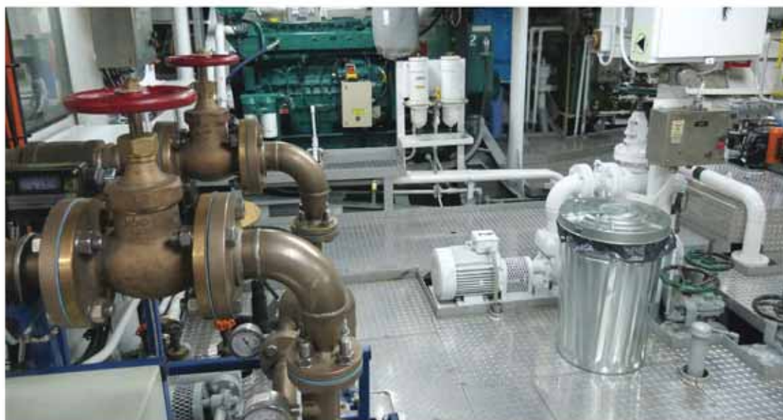
Salle des machines du N.M. Grue-des-Îles, traverse de L'Isle-aux-Grues.
